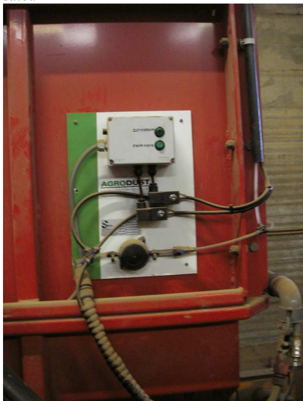
Photo 1: Tableau de commande d'un nébulisateur
