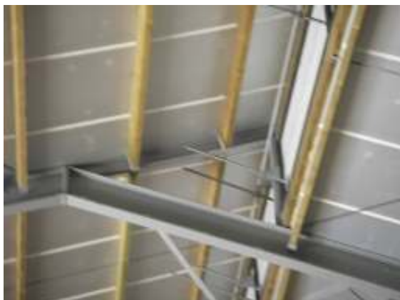
Photo 6: les volets de sortie d'air sont placés en faitière, avec des bords isolés.
