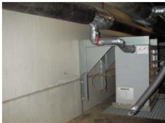
Photo 8: des tuyaux d'eau chaude pour réchauffer l'air de ventilation
