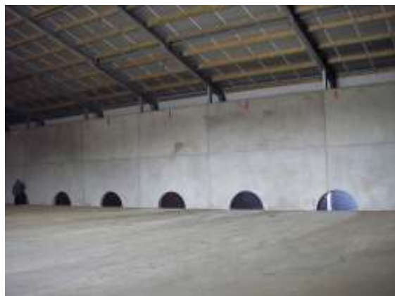
Photo 2: ventilation via un couloir technique latéral
